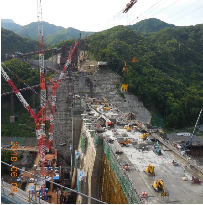
S P T 工法：らせん状パイプコンクリート運搬(左上奥)
