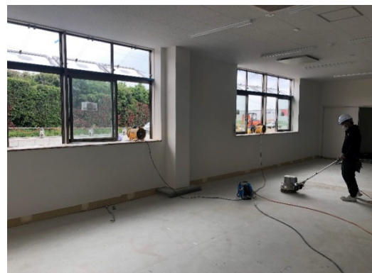
【写真①】送風機による換気(室内側)
