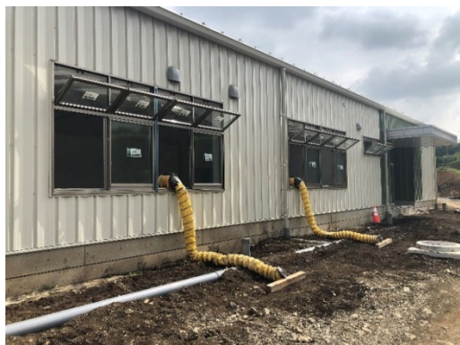
【写真②】送風機による換気(室外側)
